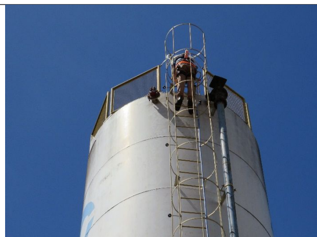
Autor: AMAE/RIO VERDE Descrição: necessidade de para-raio e sinalização noturna em condições adequadas
