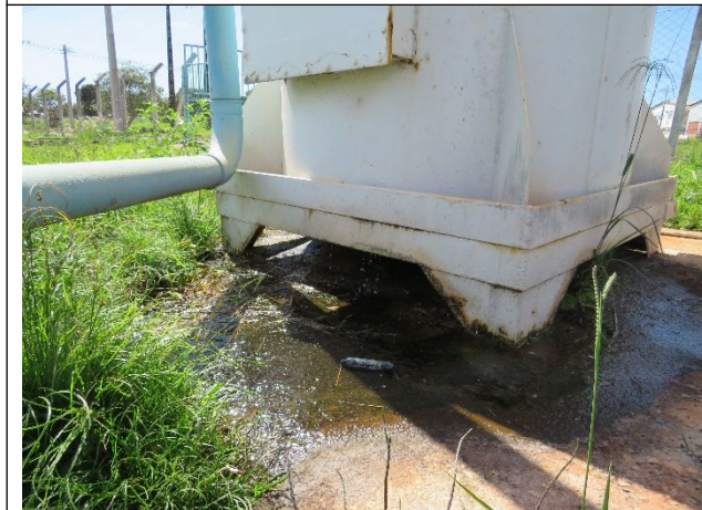
Autor: AMAE/RIO VERDE Descrição: vazamento nas instalações do REL Miriam Resende.
