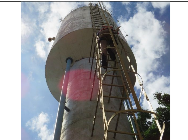
Autor: AMAE/RIO VERDE Descrição: dutos de ventilação sem proteção.
